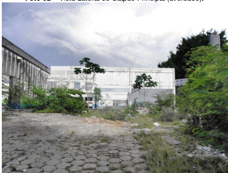
Foto 03 – Vista Frontal do Galpão Ampliação – detalhe para pátio de manobra, necessitando de recuperação da base.
