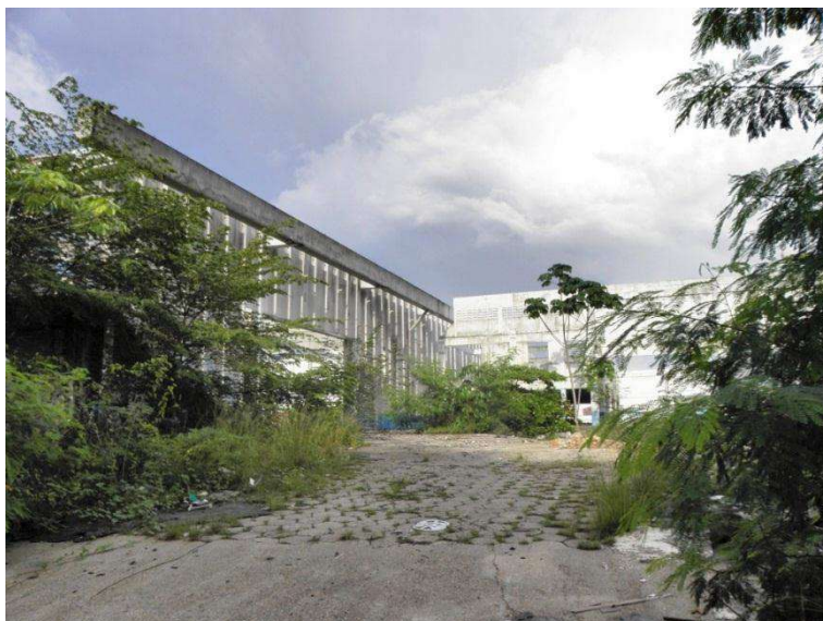
Foto 01 – Fachada dos Galpões – detalhe par abandono.
