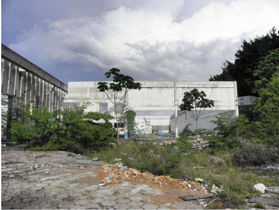
Foto 06 – Pátio de manobra e doca necessitando de compactação da base e alocação dos pavers.
